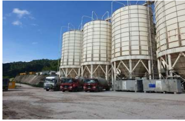
Hệ thống chứa tro bay tại công trình Nam Theun 1, Lào hiện đại
