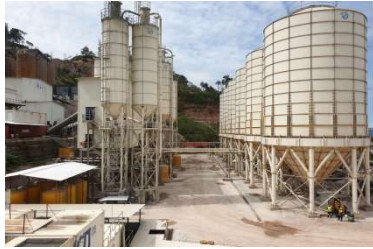
Silô chứa tro bay tại Lào
